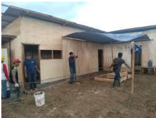
Gambar 1; Contoh Barak Pekerja dan Gudang Material
